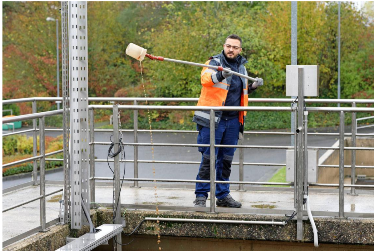
Ein Klärwerk ist ein komplexes System mit mechanischen, biologischen und chemischen Reinigungsstufen. David Uweis, der eine Ausbildung zur Fachkraft für Abwassertechnik absolviert, kontrolliert die Vorgänge. Foto: Henning Kaiser/dpa-trm
